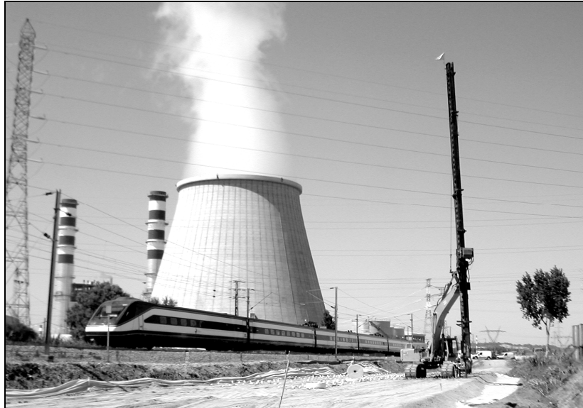
Figura 4 – Execução de geodrenos verticais no troço junto à Central Térmica do Carregado
