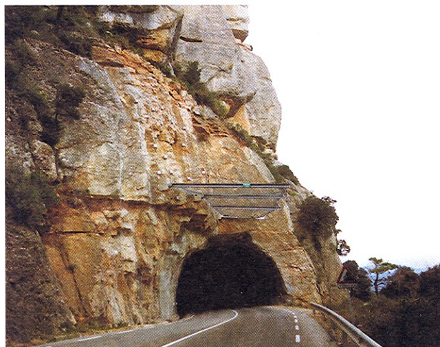
Figura 14.36 Galería dinámica horizontal en la salida de un túnel para contención de desprendimientos, Montserrat, Barcelona (cortesía de Prospección y Geotecnia, S. L.).
