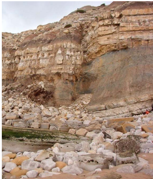
Praia Algarvia Instabilidade das falésias
