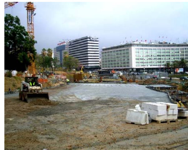
Túnel do Marquês de Pombal Que materiais, que problemas?
