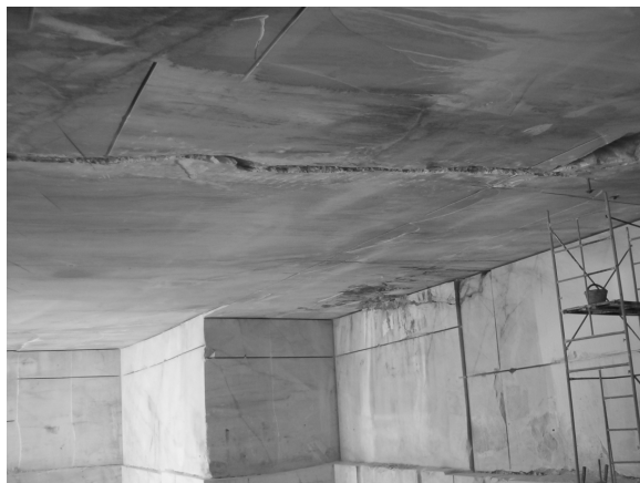
Figura 2 – Fracturação horizontal na pedreira “Texugo”.
