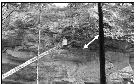
Figura 8 – Consolas existentes no Sector 2, Talude E, com balanços superiores a 3 m
