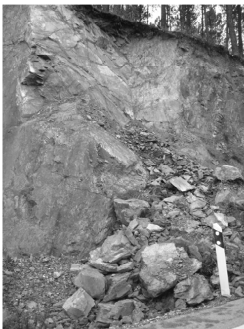
Figura 2 – Rotura em cunha no talude 1
